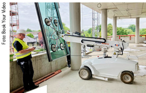
Millimeterangelegenheit: Mit Verfah- und Hebe-geräten erfolgt das Einbringen der spektakulären Feldhaus Elemente in den Baukörper.
